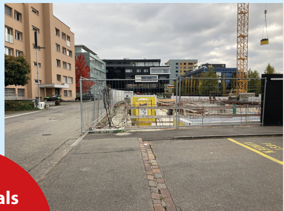
Ein Beispiel von vielen: Jahrelang versperrtes Trottoir an der Poststrasse Pfäffikon
