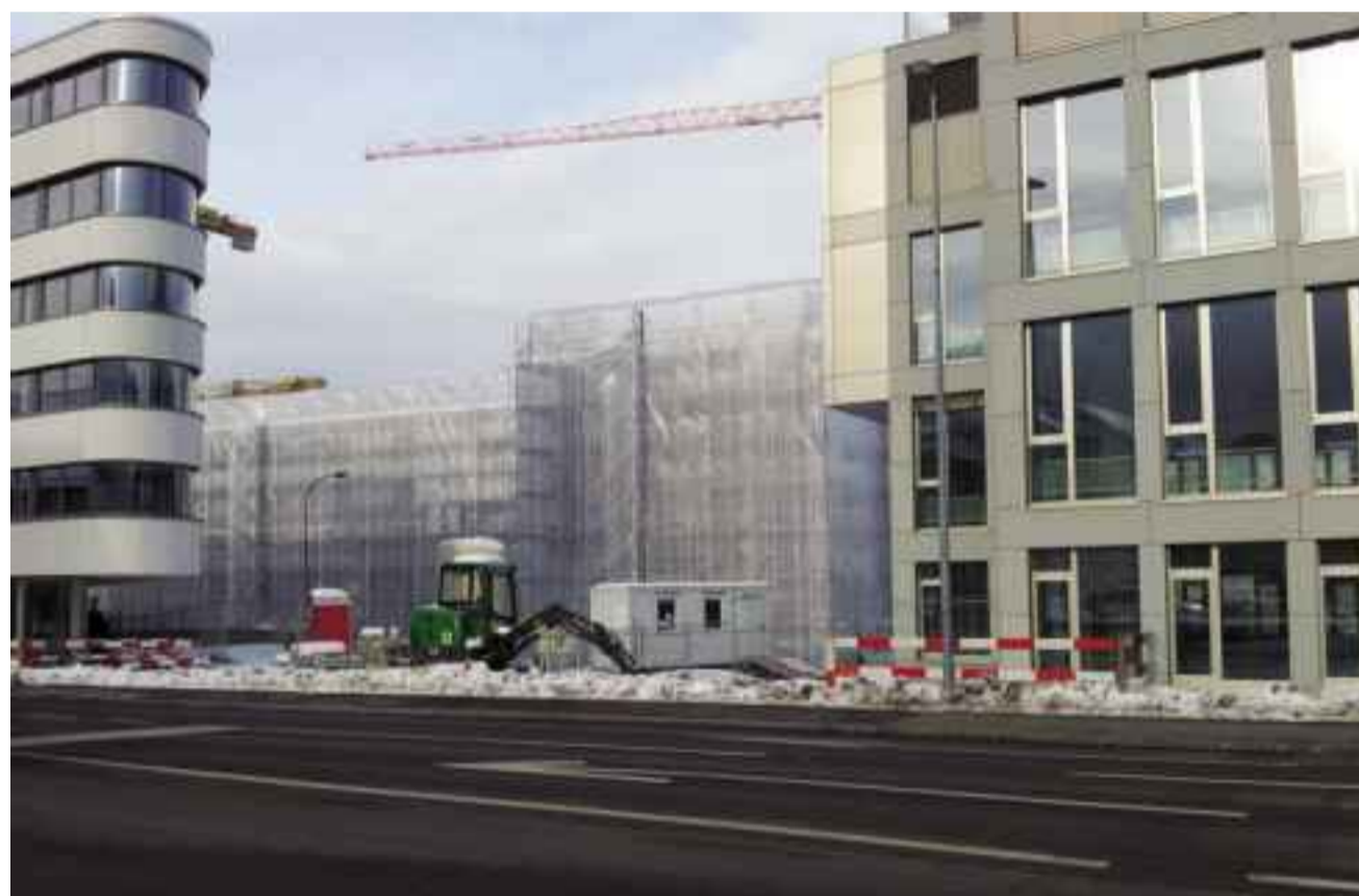
Bauen ohne genügende Erschliessung: ‚Zentrum Staldenbach‘ im Bau. Links das ‚City Gate II‘, rechts Bahnhofstrasse 1, teilweise im Rohausbau
